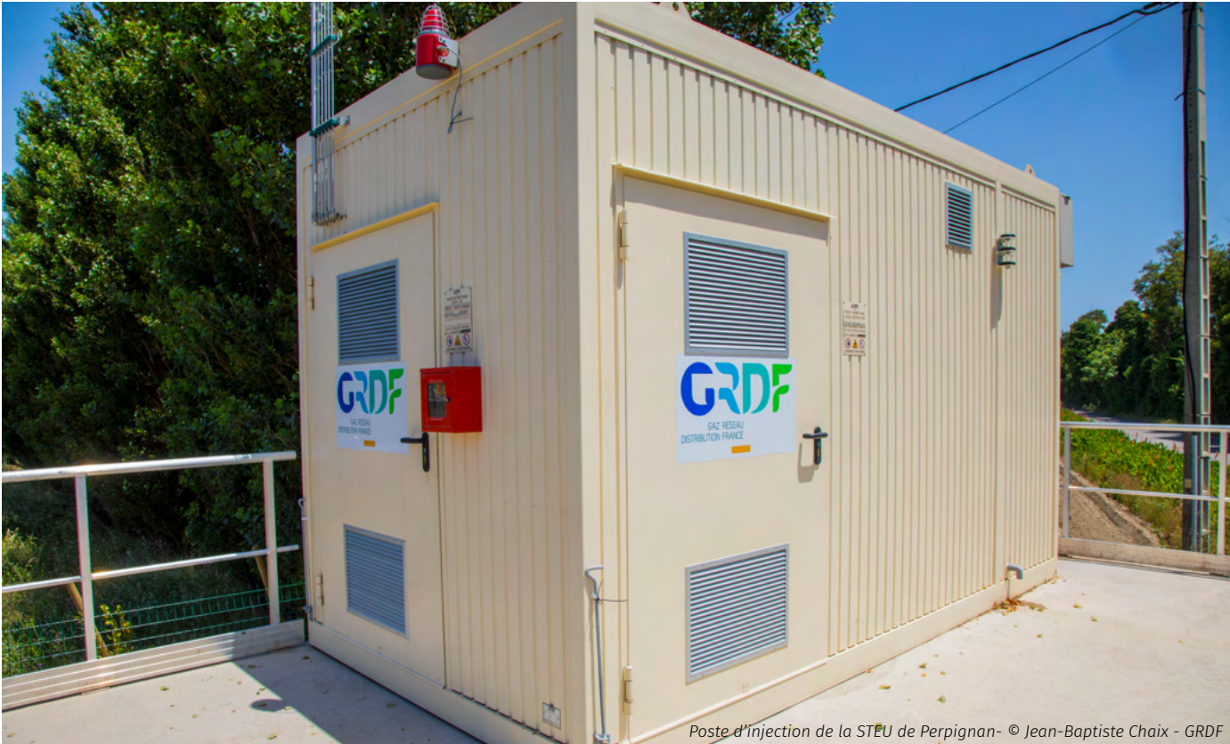
Poste d’injection de la STEU de Perpignan- © Jean-Baptiste Chaix - GRDF
