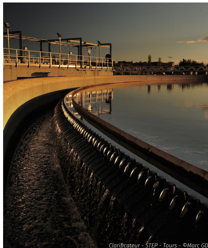
Clarificateur - STEP - Tours - ©Marc GD
